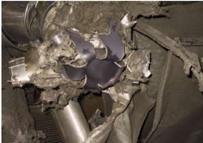
Abbildung 4.4.4 Geplatzttes Rohr im AKW Brunsbüttel (Hirsch 2005)
